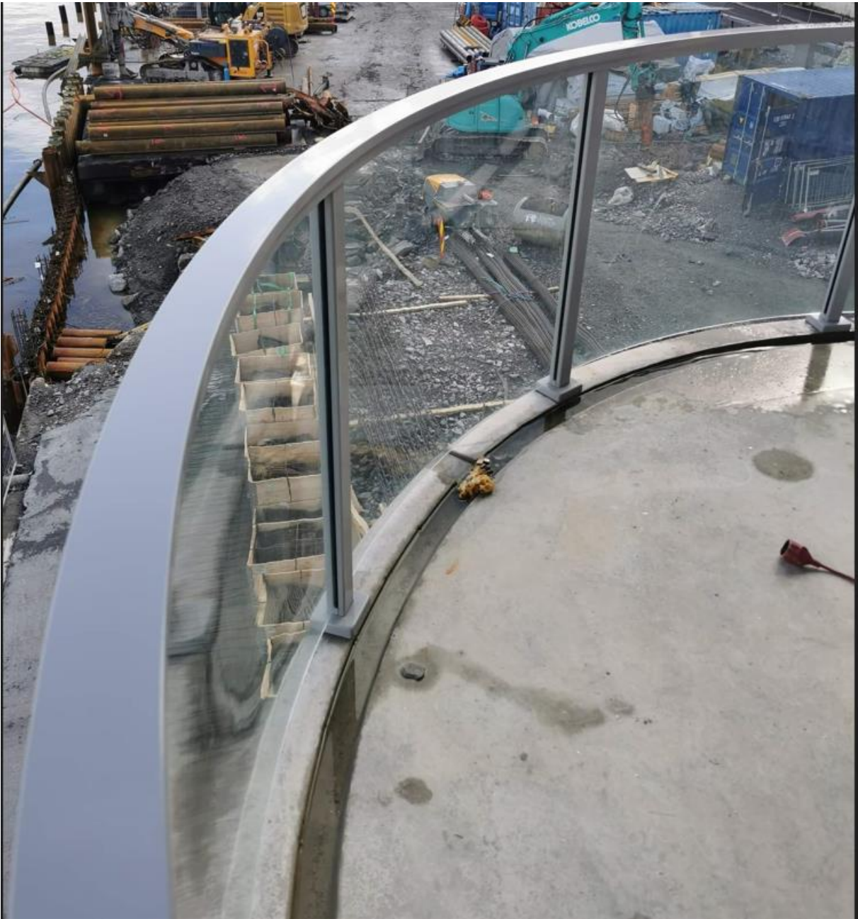
Rekkverk med bøyd topprekke og bua glass
